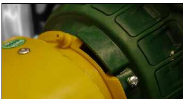
Положение внешней защитной трубы - не зафиксирована
