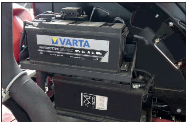
Бортовая сеть 24 В (правая сторона кабины)
