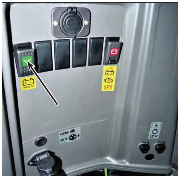
Главный выключатель аккумуляторной батареи для электропитания
